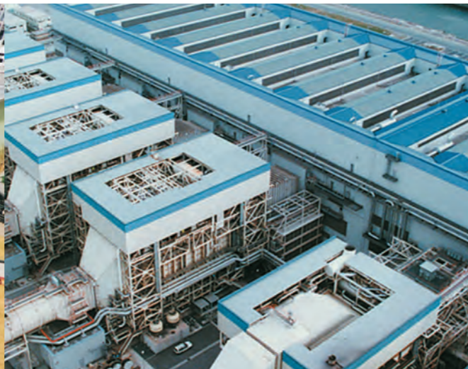
東京電力(株)千葉火力発電所
